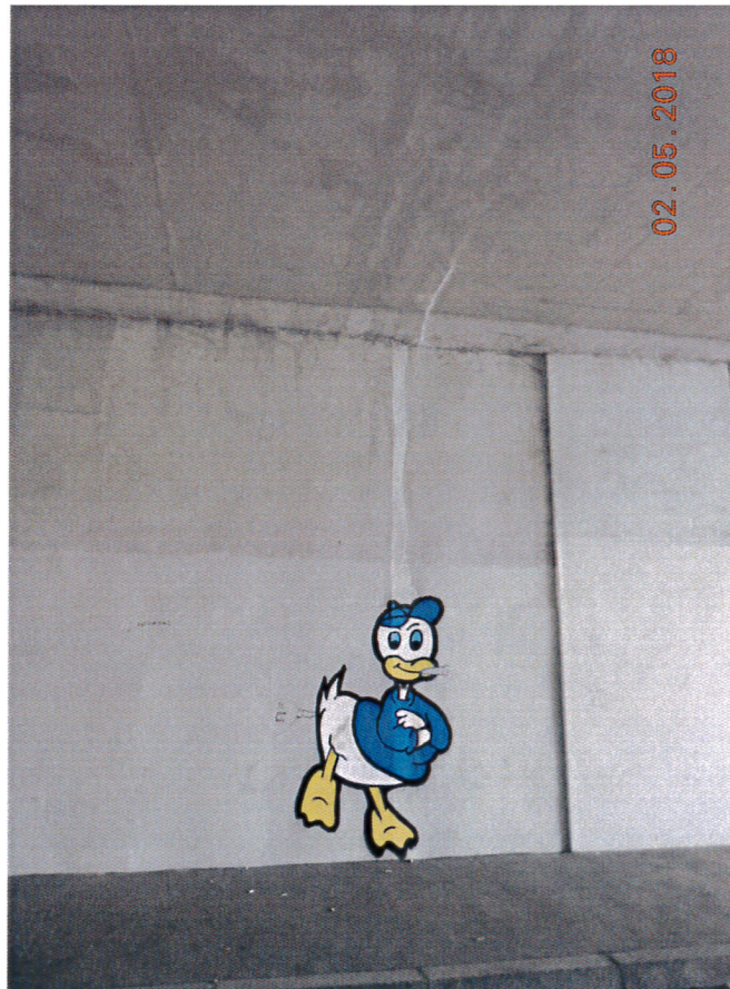
Zdj. 5. Obiekt M28 – rysa w środkowej części przejazdu w rejonie styku rygła ramy ze ścianą
