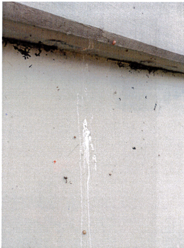
Zdj. 7. Obiekt M28 – wykwit na skrzydle od strony północnej
