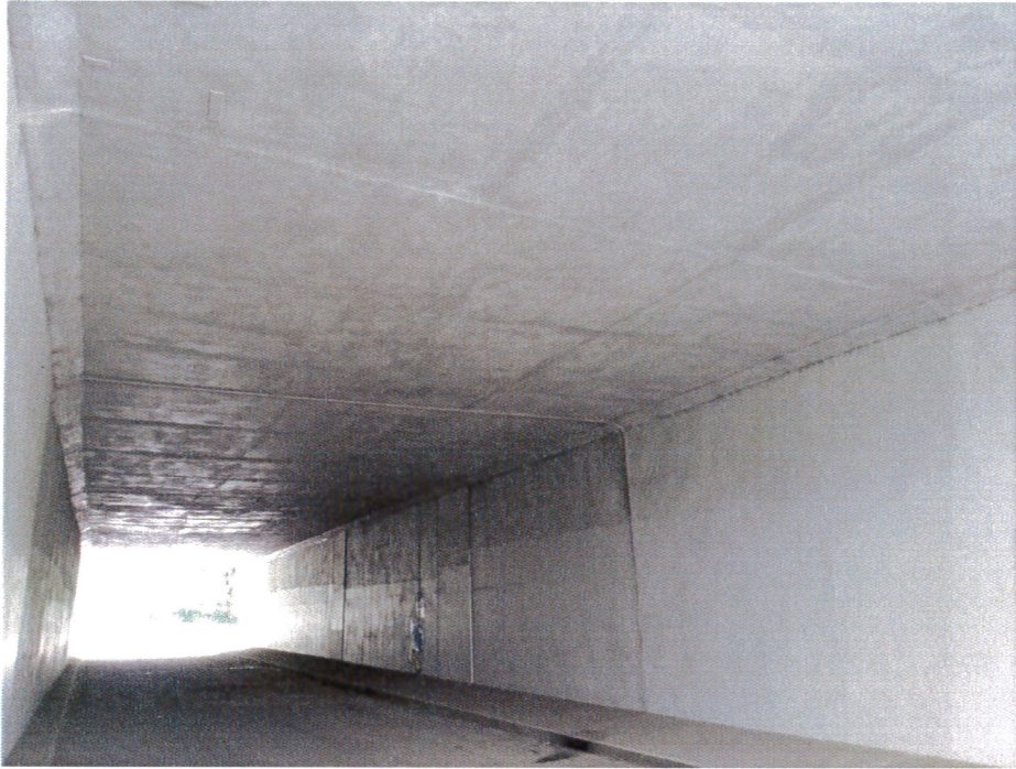
Zdj. 6. Obiekt M28 – rysa na ryglu ramy pod jezdnią w kierunku Katowic
