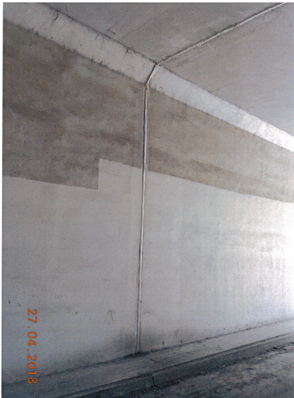
Zdj. 1. Obiekt M08 – dylatacja między segmentami ramy
